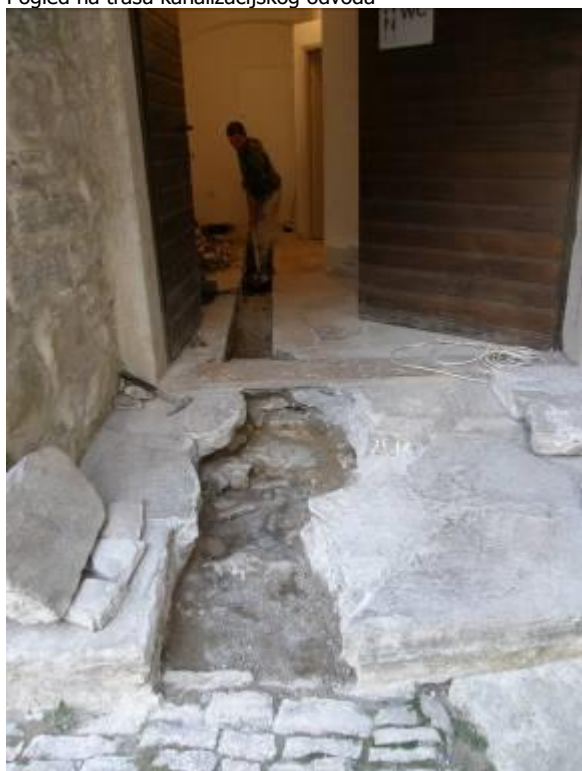
Sanitarije – kanal odvodnje
